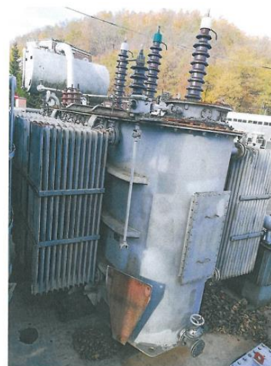
Rysunek 2. Widok transformatora od strony DN
