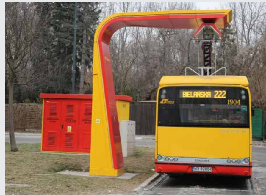
» INNOGY STOEN OPERATOR, STACJA TRANSFORMATOROWA PRZY STACJI ŁADOWANIA AUTOBUSÓW ELEKTRYCZNYCH
