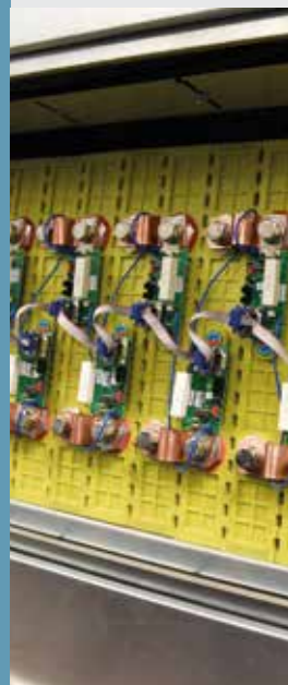
ENERGA-OPERATOR, MAGAZYN ENERGII BATERIA
